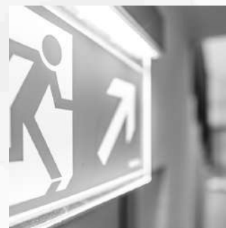
ILLUMINAZIONE DI SICUREZZA
