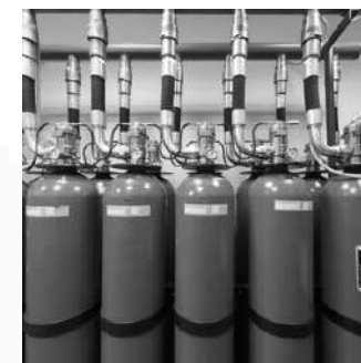
IMPIANTI DI SPEGNIMENTO A GAS INERTE
